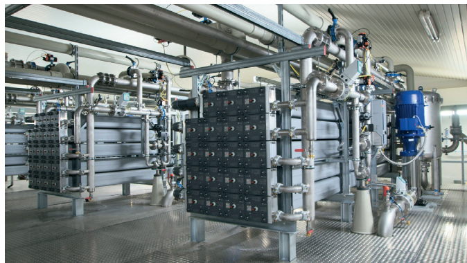
Nanofiltrationsanlage zur Enthärtung und Spurenstoffentfernung
