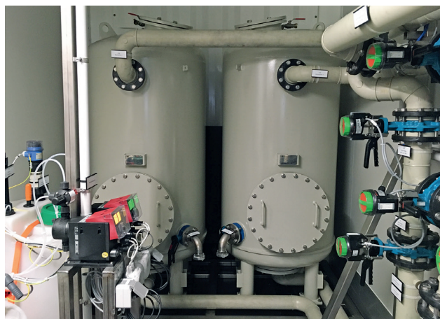
Mischbettfilteranlage (hinten) und Dosierung (links vorne)
