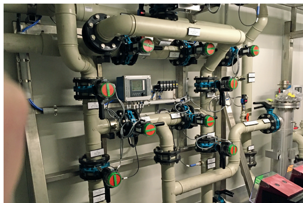
Verrohrung „Kreuz-Knobel-Schaltung“ Mischbettfilter
