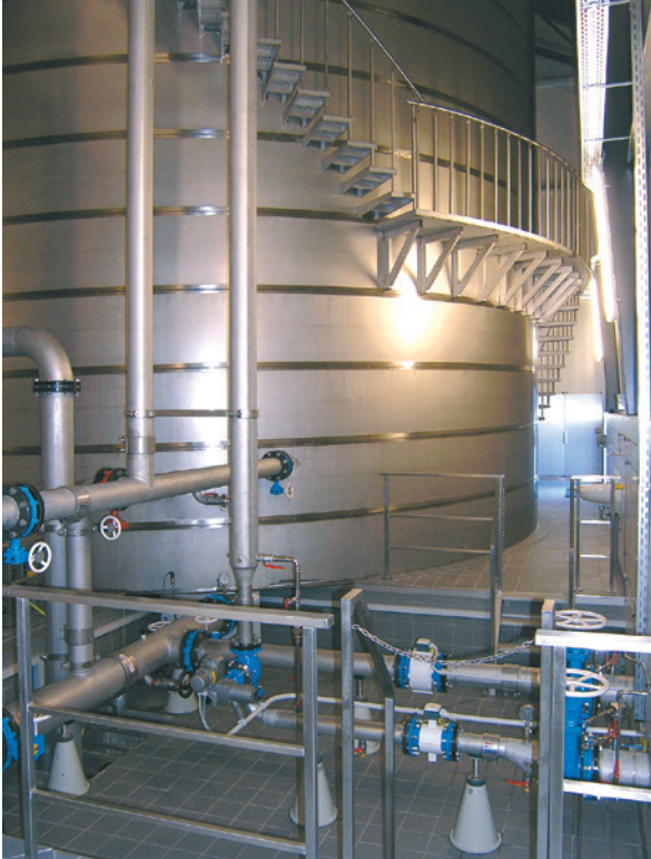
Bild 3. Behälteranlage mit Installation.
