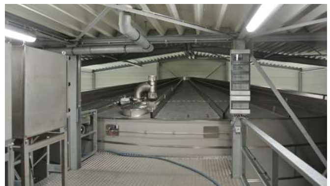
Bild 9: Obere Bedienebene der Behälteranlage
