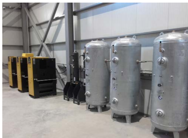
Bild 3: Kompressoranlage mit Druckluftbehältern
