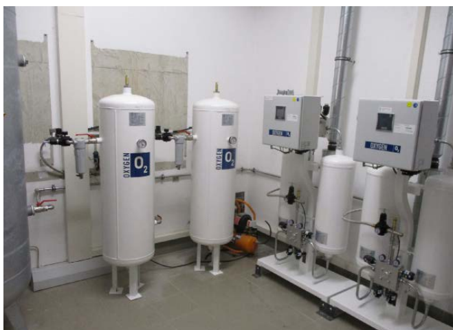
Bild 2: Sauerstoffgeneratoren mit Produkttanks
