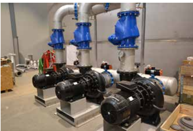
Råvannspumpene. Foto: Kjell M. Jacobsen
