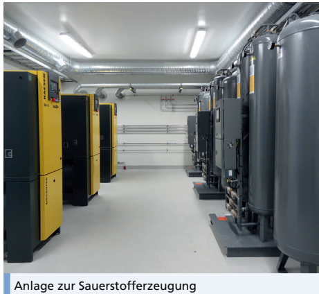
Anlage zur Sauerstoffherzeugung
