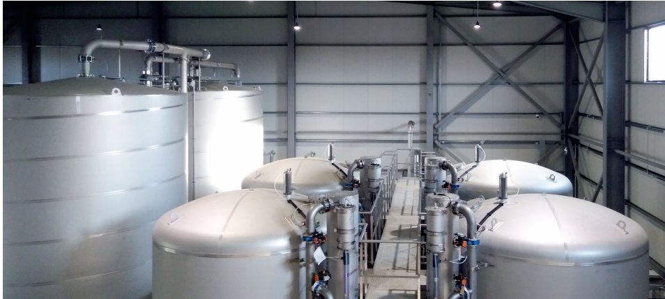
Rohwasserspeicher (links) und Wasseraufbereitung (rechts)
