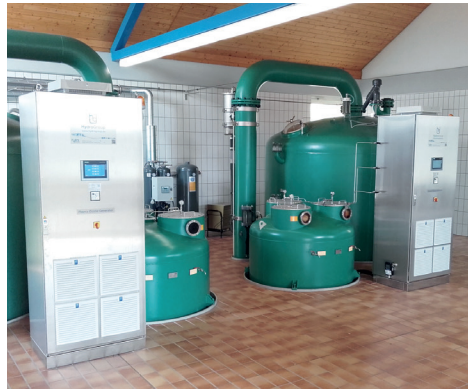
Neue Ozontechnik in einem Wasserwerk
